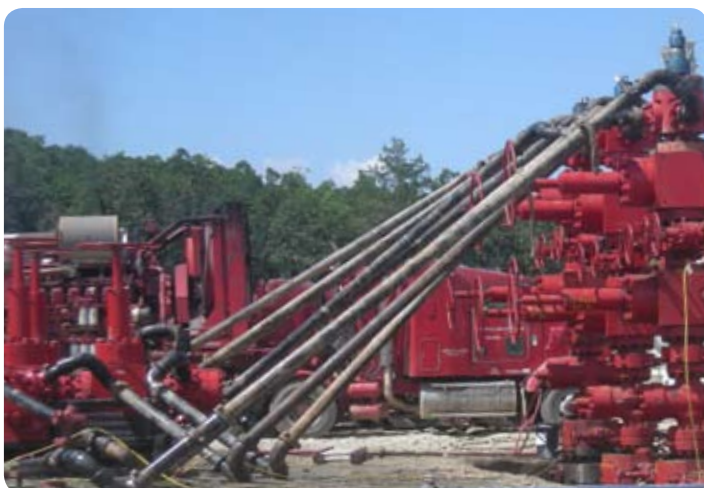
Линии обвязки, манифольд и устьевые арматуры в работе
